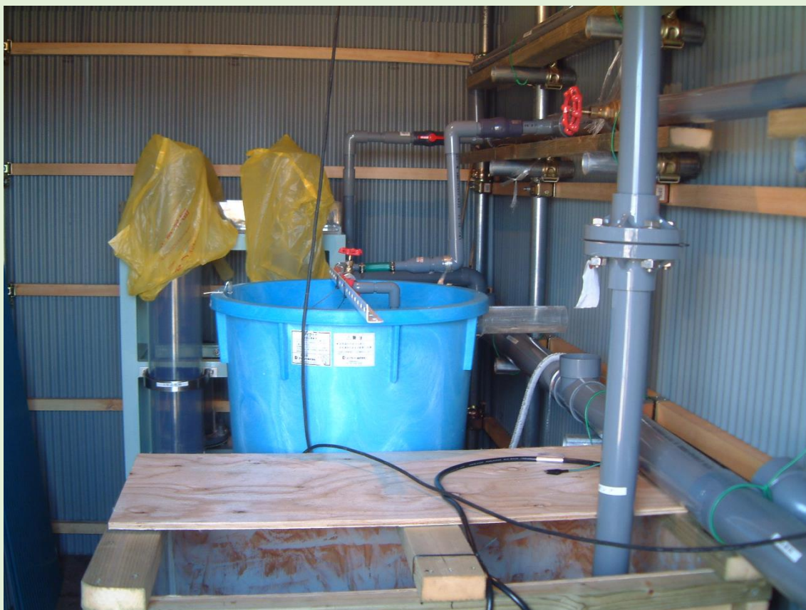
配管&給水槽（手前・木製）
