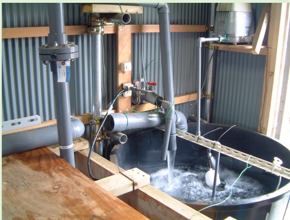
原水槽兼酸素溶解槽（稼働中）
